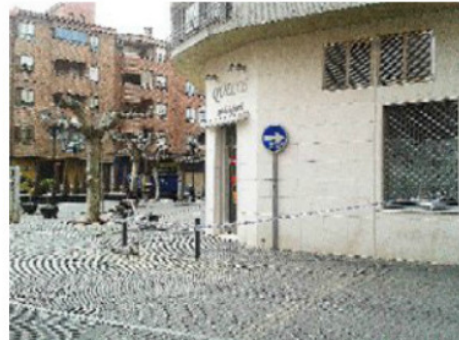
Cascotes desprendidos del balcón del cuarto piso.
