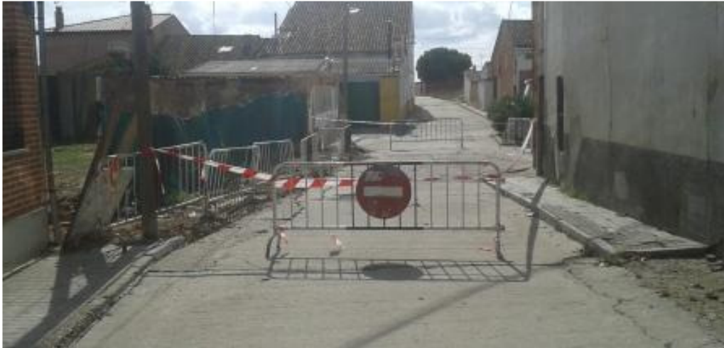
* Cierre perimetral de una zona hundida por una bodega en mal estado en Rodilana.
