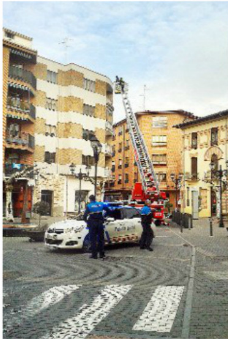
Los bomberos eliminaron las partes del balcón susceptibles de desprenderse.
